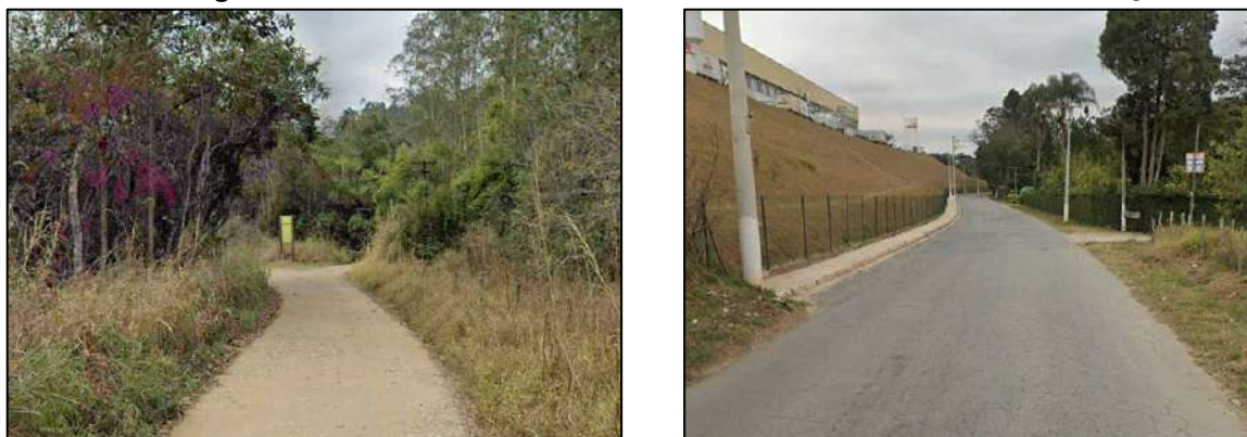
Figura 84 – Avenida PL do Brasil em diferentes estados de conservação.
