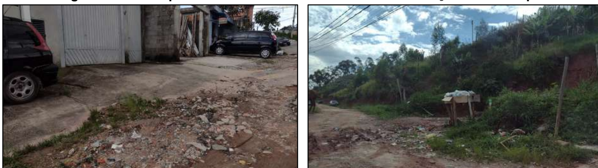
Figura 83 – Ruas pavimentadas em mau estado de conservação no Município.
