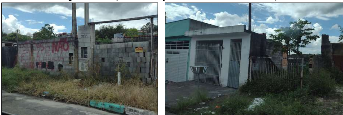
Figura 86 – Calçadas de Arujá em mau estado de conservação.
